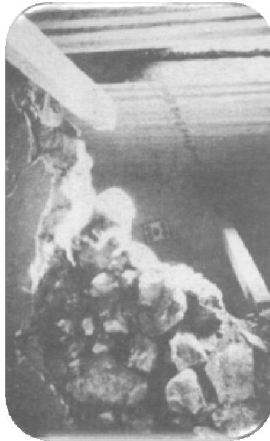
Figura 2.8 Falla local de muros de piedras en las iglesia.
