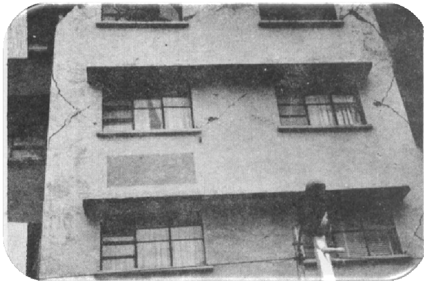
Figura 2.13 Agrietamiento por falta de refuerzo.
