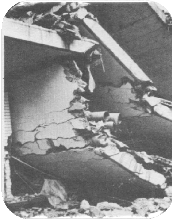
Figura 2.11 Colapso de edificios de 4 niveles.
