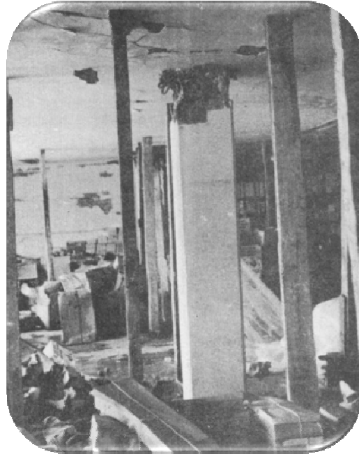
Figura 2.16 Fallas de las columnas en el 3er nivel.
